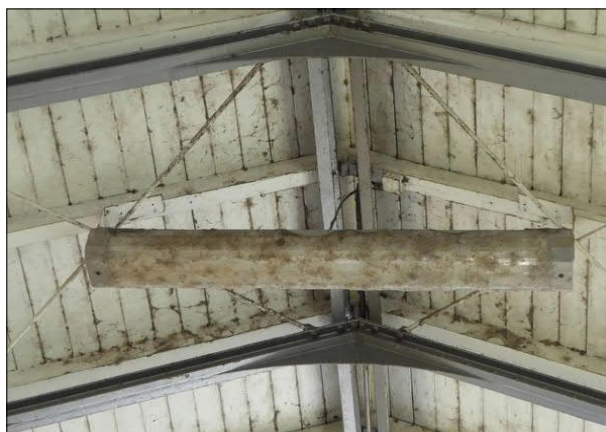
Abbildung 39: Die Leuchte in der Einhausung der Bahnsteigtreppe von Bremen-Sebaldsbrück wurde seit mehreren Jahren nicht gereinigt und ist sehr stark verschmutzt.
