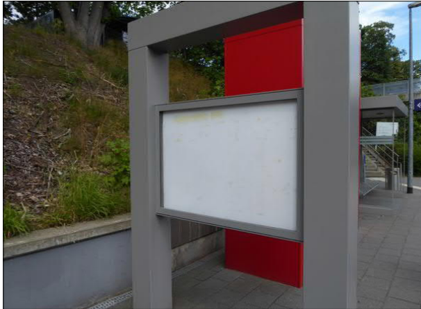
Abbildung 25: Dieser Vitrine an Gleis 2 in Bremen-Lesum fehlte die Scheibe. Es stand an dem Bahnsteig daher nur eine nutzbare Vitrine zur Verfügung.
