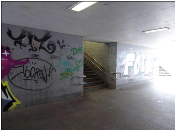
Abbildung 34: Die Wände des Tunnels zum Erreichen der Bahnsteigtreppe in Bremen-Hemelingen waren großflächig beschmiert.
