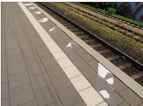
Abbildung 9: In Bremen-Oslebshausen war die Gefahrenbereichsmarkierung beschädigt.
