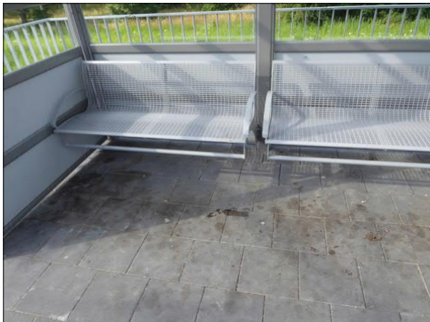
Abbildung 11: Das noch nicht einmal ein Jahr alte Bahnsteigpflaster in Bremen-Oberneuland ist im Bereich der Unterstände bereits deutlich verschmutzt.
