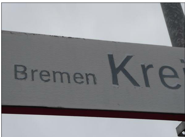
Abbildung 21: An einzelnen Schildern der Stationen im Bereich der FVE ist ein beginnendes Ablättern der Beschriftung zu beobachten. Das trifft auch auf dieses Bahnhofnamensschild in Bremen Kreinsloger zu.
