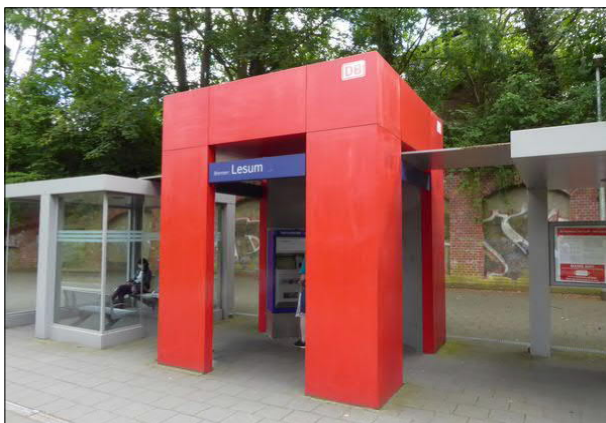
Abbildung 12: Die farbigen Flächen der Wetterschutzmodule in Bremen-Lesum sind neu gestrichen worden. In den letzten Jahren wurde das Erscheinungsbild durch stark verblasste Farbe und Verschmutzungen beeinträchtigt.
