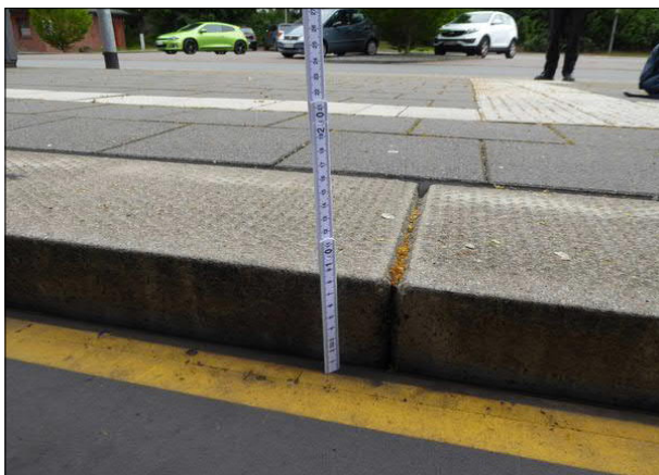
Abbildung 6: In Bremen-Farge wurde am Einstieg einer Regio-S-Bahn ein Höhenunterschied von gut 8 cm zwischen der Bahnsteigoberfläche und der Trittstufe gemessen. Mehr als 3 cm hohe Stufen gelten nicht mehr als uneingeschränkt barrierefrei.
