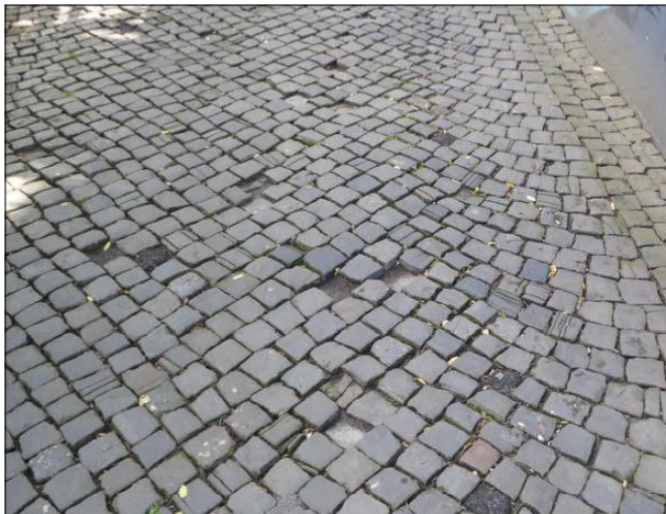
Abbildung 35: Die südliche Rampe der Unterführung in Bremen-Sebaldsbrück weist zahlreiche Pflasterschäden auf.
