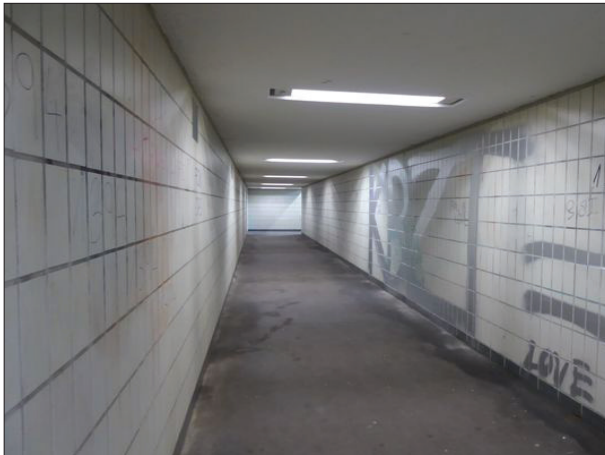
Abb. 43: Im Bahnsteigtunnel von Lemförde waren die Wände bekratzelt und beschmiert.
