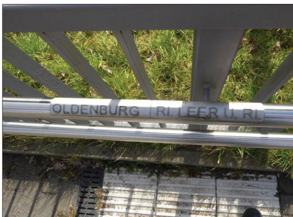
Abb. 30: In Oldenburg-Wechloy sind die Schilder der taktilen Wegeleitung an der westlichen Rampe falsch angeordnet.
