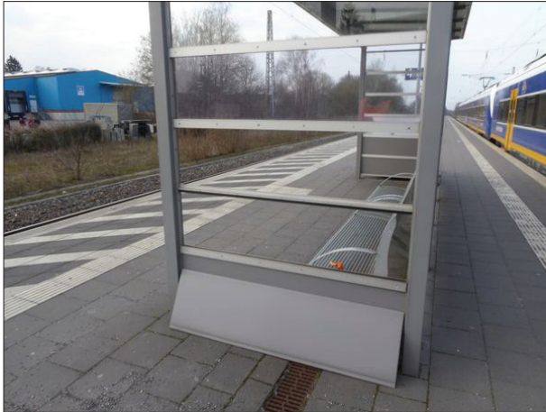
Abb. 58: An den Unterständen auf dem Mittelbahnsteig in Syke waren einige Schäden zu verzeichnen.
