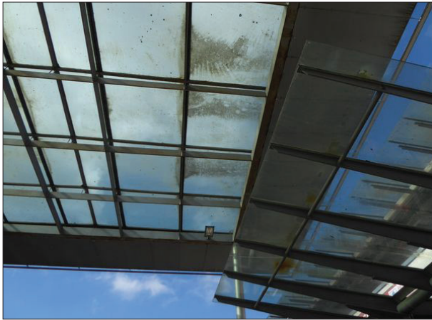
Abb. 40: Die Vordächer an den Eingängen des Bahnhofs Delmenhorst sind stark verschmutzt und weisen Schäden auf.
