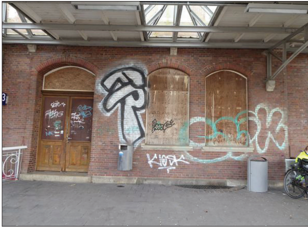
Abb. 52: Die Schmierereien und Schäden an der bahnsteigseitigen Fassade des ehemaligen Empfangsgebäudes beeinträchtigen den Wartekomfort in Brake.
