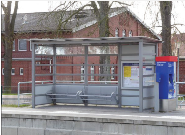
Abb. 16: An beiden Unterständen fehlten in Rodenkirchen jeweils neun Scheiben. Zudem waren an jedem Unterstand vier weitere Scheiben stark beschädigt.
