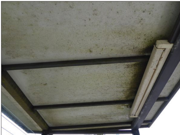
Abb. 14: An mehreren Stationen beeinträchtigten verschmutzte Decken und Leuchten das Erscheinungsbild der Unterstände. Auch in Wremen war das der Fall.
