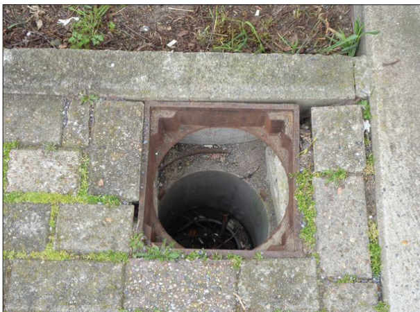
Abb. 9: In Lemförde fehlte an Gleis 2 der Gullideckel direkt neben dem Fahrgastunterstand.
