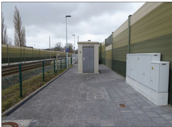
Abb. 2: Mitten im Zugang zum Bahnsteig Richtung Oldenburg steht in Jaderberg ein Betonschaltheus. Das ist nicht nur gestalterisch, sondern auch funktional unbefriedigend.
