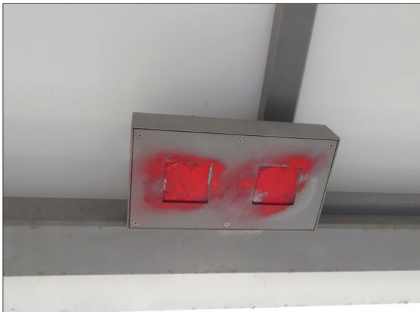
Abb. 53: In einem Fahrgastunterstand auf dem Mittelbahnsteig von Ottersberg waren die Leuchten mit Farbe besprüht.
