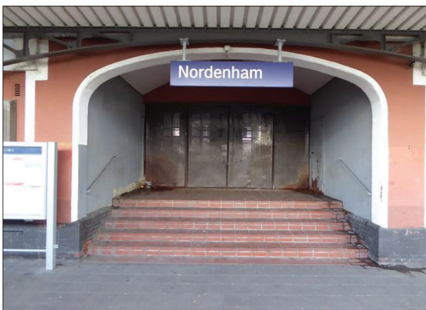
Abb. 12: Der ehemalige Zugangsbereich zum Bahnhofsgebäude in Nordenham war verunreinigt. Uringeruch verbreitete sich von dort auf den Bahnsteig.
