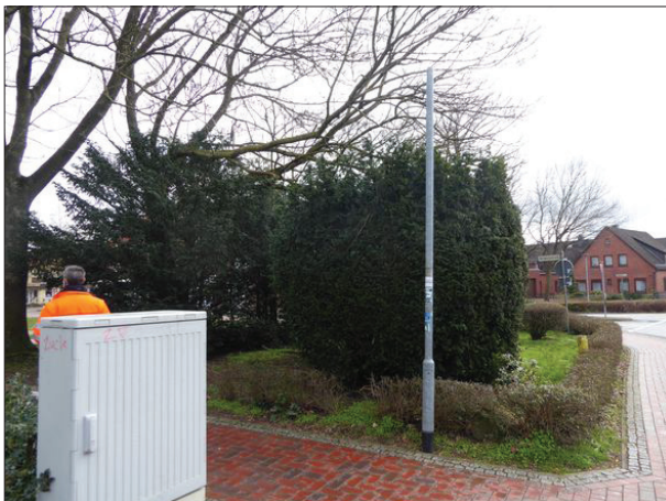
Abb. 48: In Ganderkesee fehlte an einem Lichtmast im südlichen Zugangsbereich ein Lichtkopf.
