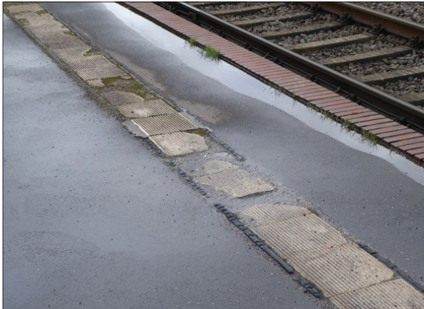
Abb. 10: Der Blindenleitstreifen im östlichen Bereich des Bahnsteigs in Oldenburg Hbf ist stark beschädigt.
