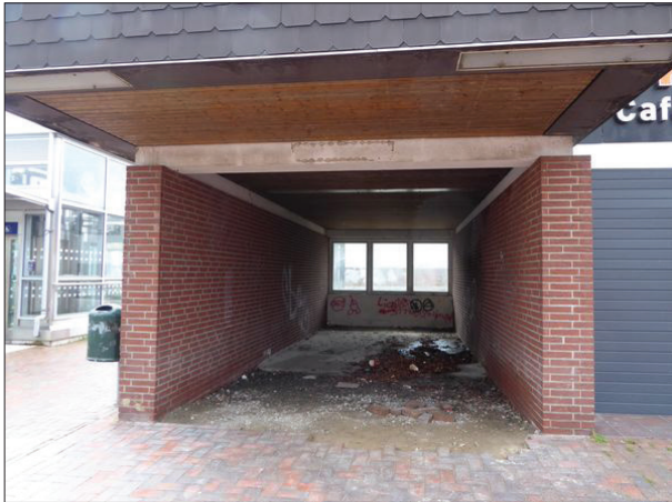
Abb. 49: Der zugeschüttete aber ungenutzte ehemalige Tunnelleingang in Rastede beeinträchtigt das Erscheinungsbild im Zugangsbereich.
