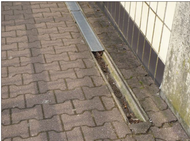
Abb. 44: An der südlichen Rampe der Unterführung am Bahnhof Ottersberg fehlte ein Abdeckblech der Entwässerungsrinne.
