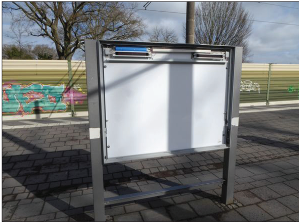
Abb. 31: Die Vitrine am Bahnsteigzugang in Bookholzberg war beidseitig ohne Scheiben und unbestückt.
