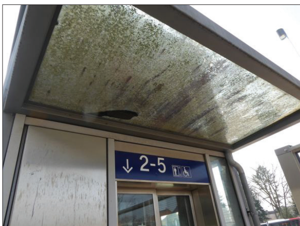
Abb. 57: Die Vordächer an den Aufzügen zu den Bahnsteigen in Verden waren stark verschmutzt.
