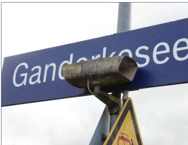
Abb. 27: Ungünstig ist, dass in Ganderkese die Lautsprecher ohne Abstand zu den Bahnhofnamensschildern installiert wurden, so dass diese teilweise verdeckt werden.
